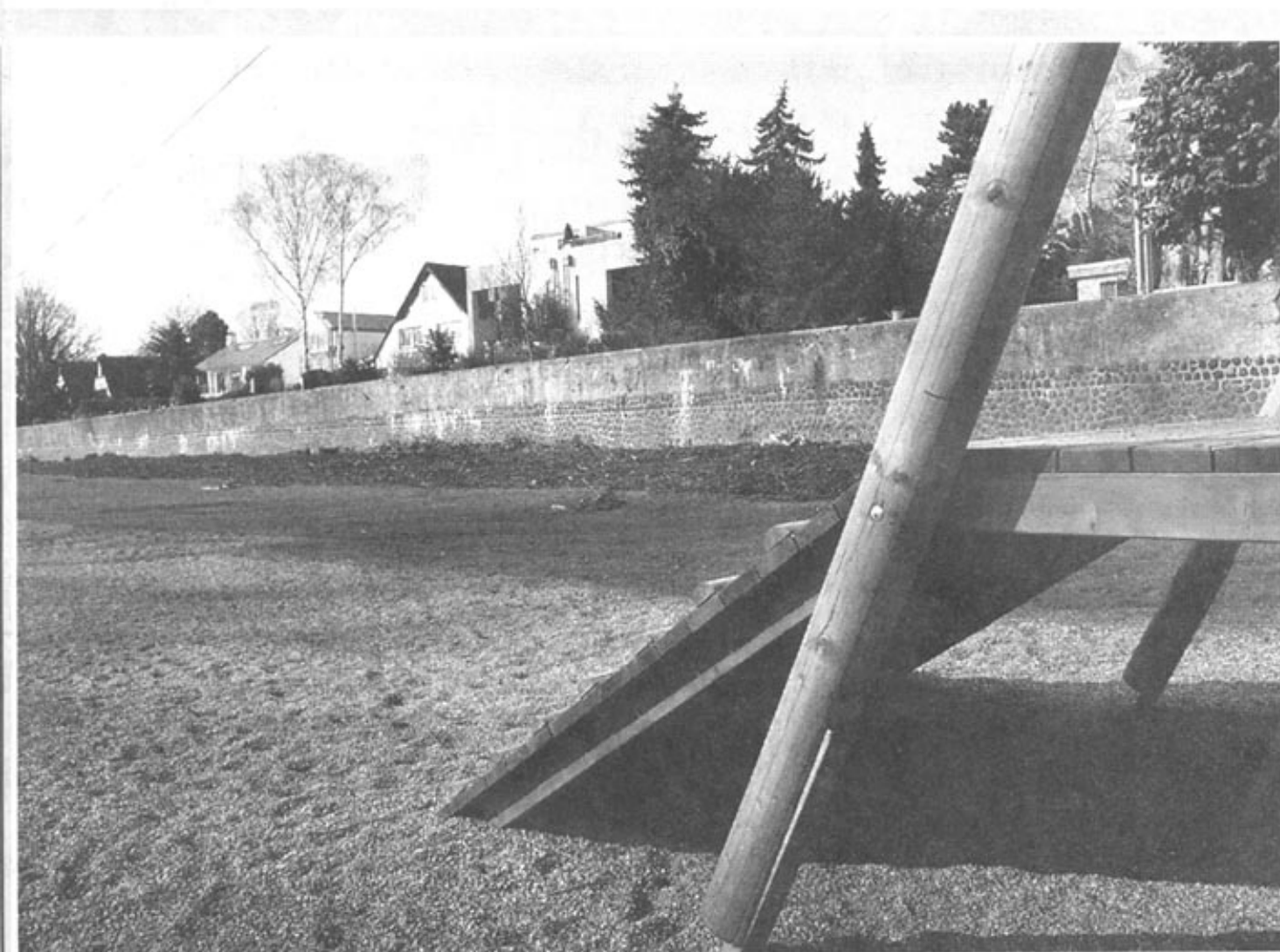
Die vorhandene Hochwasserschutzwand am Sürther Spielplatz ist nicht mehr standsicher. Sie wird dennoch nicht abgebrochen, sondern durch ein inneres Ankersystem stabilisiert.
